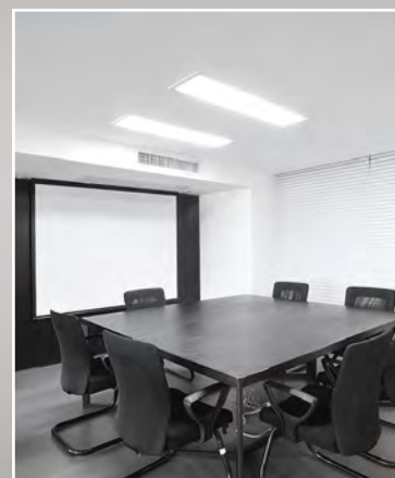
LEO L-123-R to duże podłużne panele świetlne z serii Leo – efektywnie wykonanych, nowoczesnych, ekologicznych i wydajnych opraw oświetleniowych LED.
