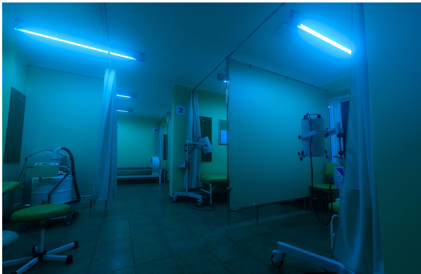
Gabinety zabiegowe dezynfekowane oprawami sufitowymi
